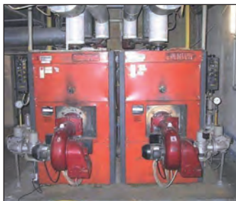
Die zentralen Wärmeversorgungsanlagen vor
