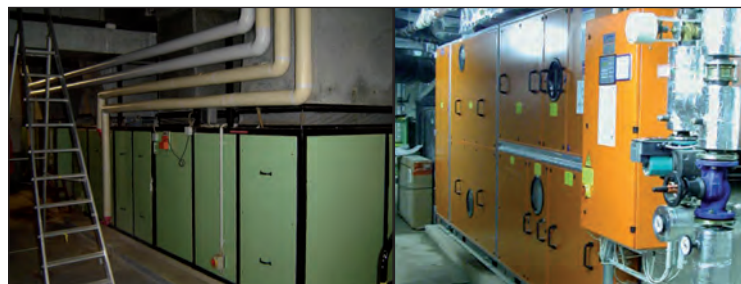
Die zentralen Lüftungsanlagen vor
