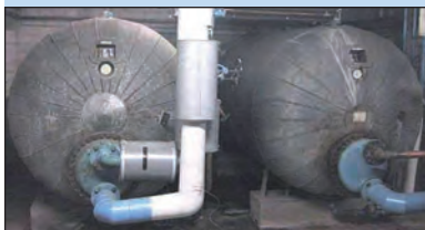
Zentrale Warmwasserbereitung vor
