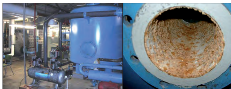
Zustand der Filterbehälteranlagen vor der Sanierung
