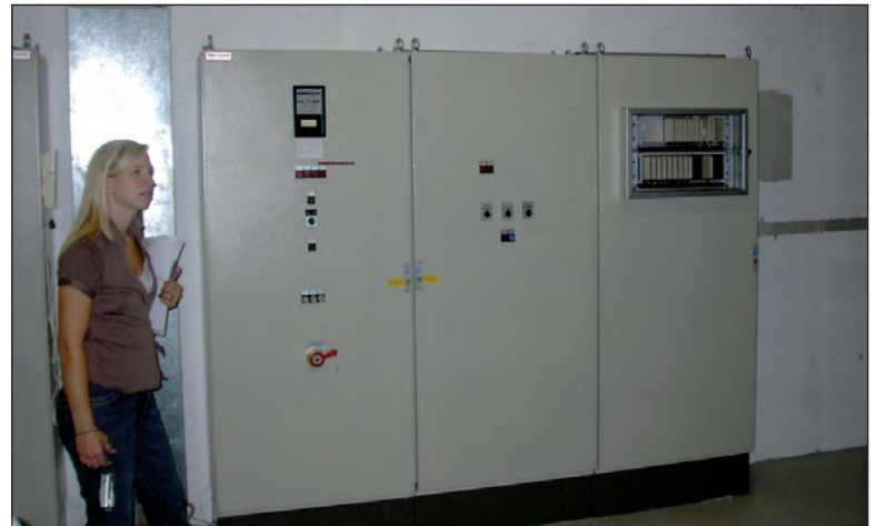
Contracting eignet sich für die Optimierung und Sanierung von Energieerzeugungs- und -verteilungsanlagen
